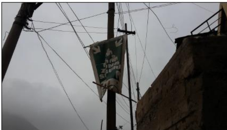
Fotografía 5: Señalización de zona segura mal ubicado en la aso. Comité Hogar Buenos Aires
