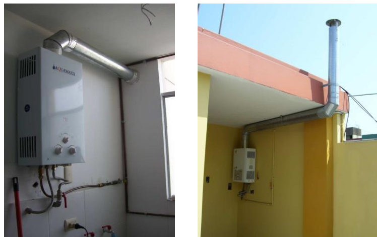
Fig. 15 – Fotografías de vistas de ductos de evacuación de gases producto de la combustión.
