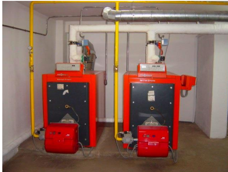
Fig. 01 – Imagen de unas Calderas a gas.
