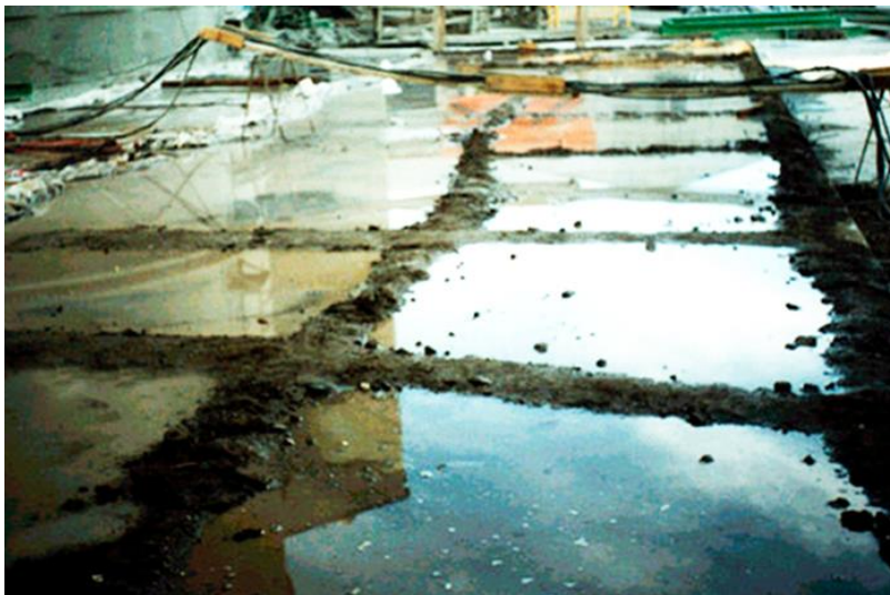
Fig. N° 26, Sistema de arroceras: (inundación) para pisos o techos. Es necesario evitar que el agua de las arroceras se caliente.
